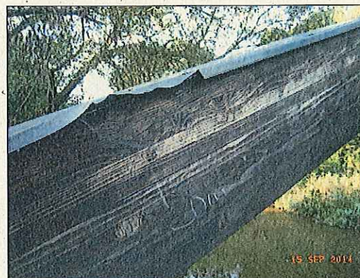
Abb. 45: Hängewerk, vorn links Blechabdeckung beschädigt
