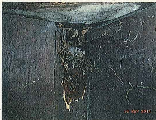
Abb. 14: Geländer, Verankerung Distanzstück Innenfäule
