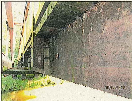
Abb. 48: Längsträger, Geländerverankerung Distanzstück fehlt
