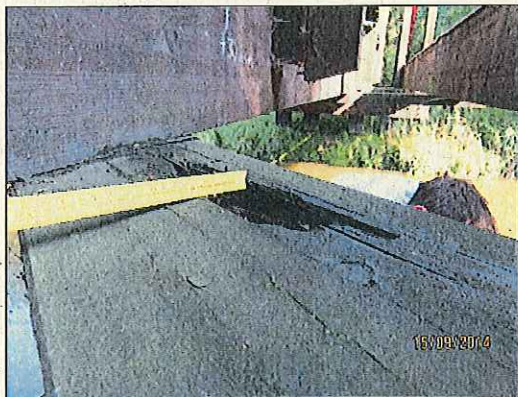
Abb. 42: Hängewerk, Aussteifung BSH gerissen & mit Innenfäule
