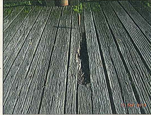
Abb. 31: Bohle Detail morsch & Durchbruch
