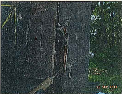
Abb. 26: Geländerpfosten Verankerung mit, Innenfäule, morsch
