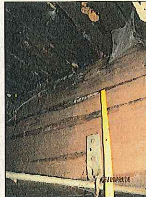
Abb. 07: Feld 5 Längsträger links innen, in Lammellen durchfeuchte & Myzelen
