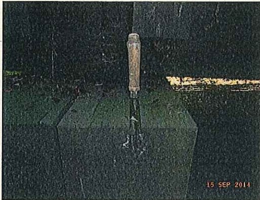
Abb. 24: Stütze 11 – Kopfbalken rechts, gerissen Innenfäule
