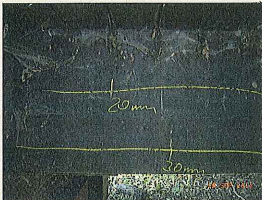
Abb. 18: Feld 10 rechts außen, BSH – Binder gerissen
