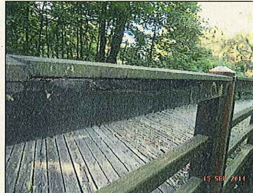
Abb. 13: Geländer, Detail Handlauf Profil gebrochen
