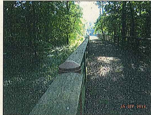
Abb. 25: Geländer nicht im Lot, nach außen verbogen
