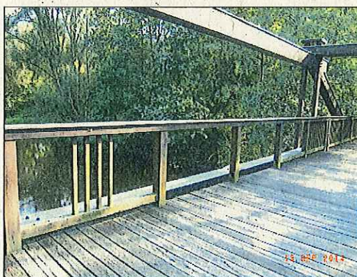
Abb. 50: Geländer, beschädigt durch Fremd
