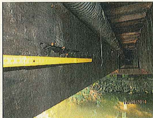
Abb. 43: Hängewerk, Längsträger BSH gerissen Lamelle angefault
