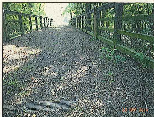
Abb. 29: Bohlenbelag verschmutzt & bewachsen
