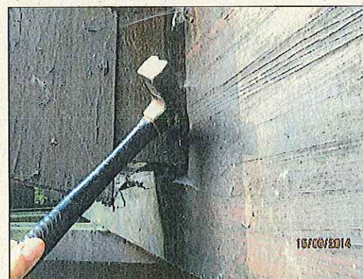
Abb. 47: Längsträger, Geländerverankerung Distanzstück mit Innenfäule
