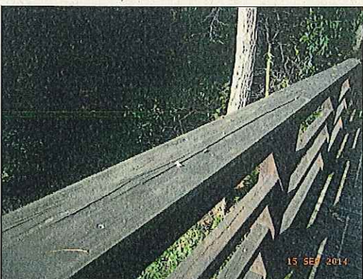
Abb. 28: Geländer, Handlaufabdeckung gerissen
