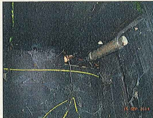
Abb. 21: Feld 13 rechts oberer geschädigt, mit Innenfäule
