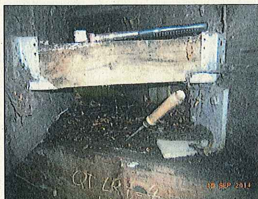
Abb. 10: Detail Kopfbalken verschmutzt & durchfeuchtet
