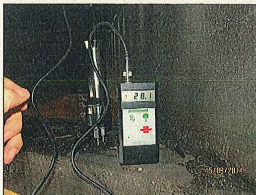
Abb. 41: Aussteifung Profil durchfeuchtet Feuchtegehalt >20%
