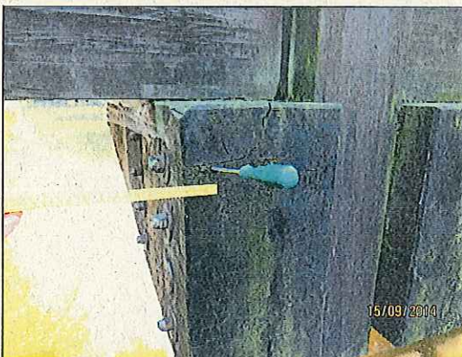
Abb. 38: Hängewerk, Querträger BSH gerissen durchfeuchtet
