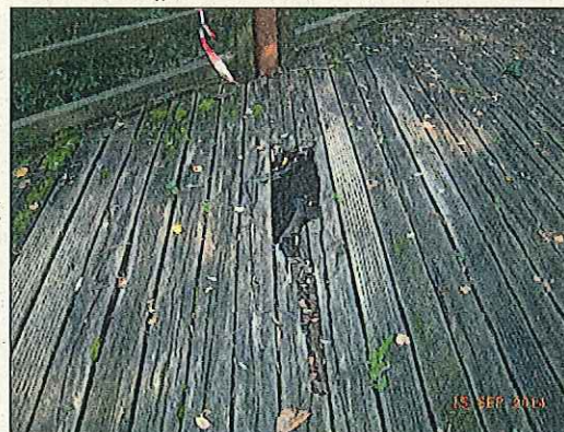
Abb. 17: Bohlenbelag, Durchbruch, durch Innenfäule
