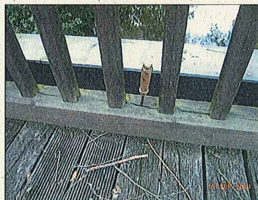
Abb. 51: Geländer, Detail Profile gerissen
