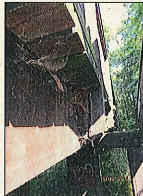
Abb. 49: Längsträger, Geländerpfosten mit Innenfäule
