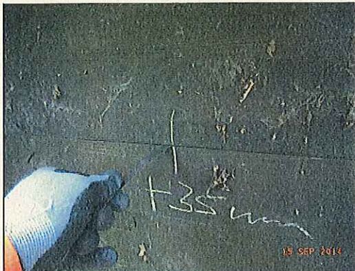
Abb. 06: Feld 1 Längsträger links außen, in Klebefuge gerissen, Risstiefe 35mm
