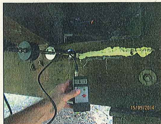
Abb. 09: Stütze 3 Kopfbalken durchfeuchtet & mit Myzelen
