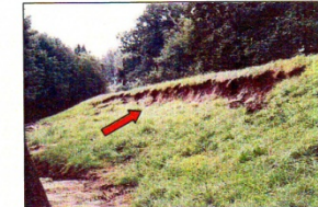
Rutschungen am Deich
