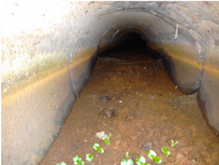
Zustand vor Instandsetzung
