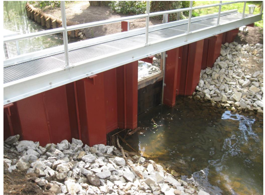
Staubauwerk mit Meldepegel
