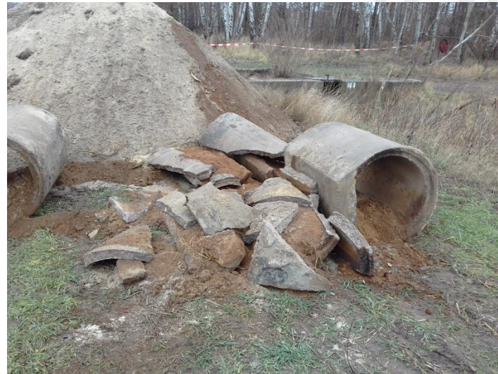
Defekte alte Rohrstränge
