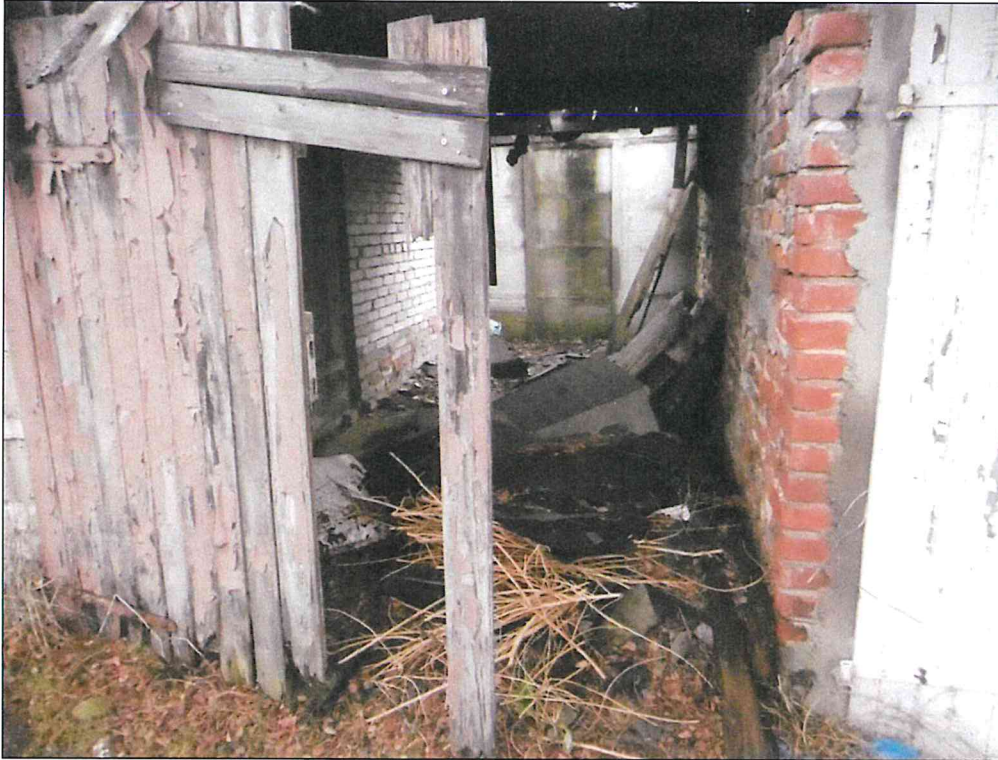
Foto 7: auflässige ehemalige Garage im Westbereich Flurstück 283 mit starken Vermüllungen
