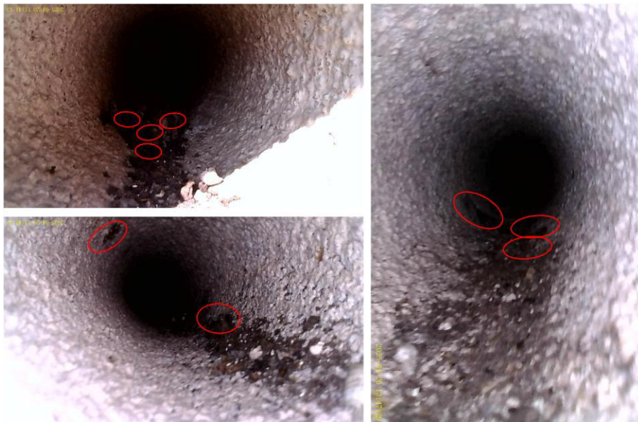
Abbildung 30: Exemplarische Exkrementfunde von Kleinfledermaus in den Hohlräumen der Fertigbetondeckenplatten (Quelle: BAGU, 2025)
