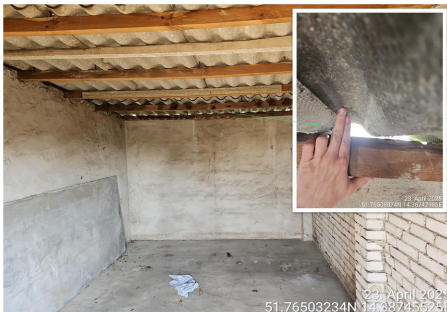
Abbildung 10: Detailaufnahme von den faunistisch relevanten Spaltmaßen (Quelle: BAGU, 2025)
